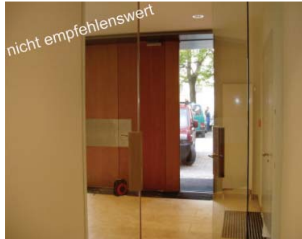
Bild 9 Schwer erkennbare Glastüren (Tür im Windfang eines Mehrfamilienhauses)
