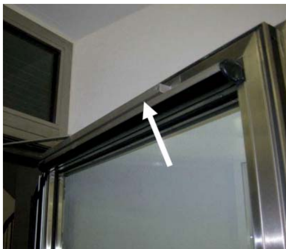
Bild 6 Infrarotvorhangschiene zur Anwesenheitskontrolle (weißer Pfeil) Quelle: Firma Bircher Reglomat AG, CH-Beringen
