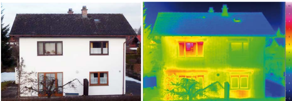
Bild 9 Wohnhaus, Mauerwerk, Baujahr 1960 links: Photographie am Vortag aufgenommen rechts: Thermographie eine Stunde vor Sonnenaufgang Randbedingung: Außentemperatur 2°C bedeckt leicht windig EG: neue Kunststoffenster mit U_w=1,4 ; OG: Holzverbundfenster, linker Raum wenig, rechter Raum unbeheizt, trotzdem ist die Glasfläche des dreiteiligen Fensters wärmer ( U_g=3,0 ) Achtung: die „warme“ Fläche ist eine Reflexion des gegenüberliegenden Gebäudes (offene Tür); die unterschiedliche Wandtemperatur von EG und OG ist Folge der unterschiedlichen Raumtemperatur, erkennbar ist die Deckeneinbindung.
