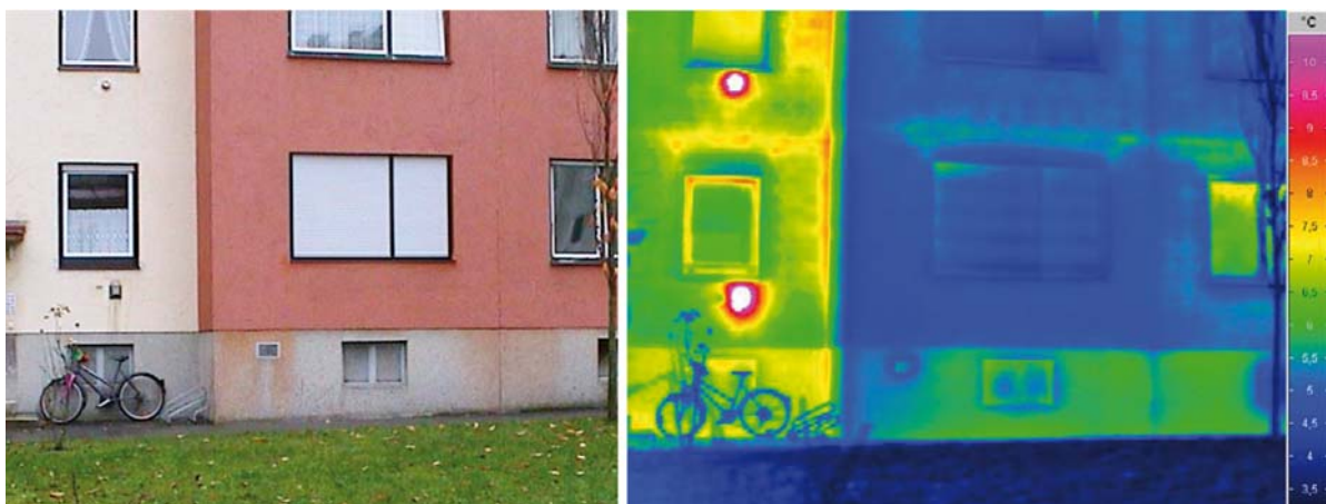
Bild 20 Mehrfamilien-Wohnhaus, Baujahr: 1960 teilsaniert 2001; Kunststofffenster U_w=1,4 \text{ W}/(\text{m}^2\text{K}) mit Außenrollo; Randbedingung: Außentemperatur 4°C bedeckt, leichter Regen, windstill; links: neue Fenster U_w=1,4 \text{ W}/(\text{m}^2\text{K}) ; rechts: neue Fenster und Wärmedämmverbundsystem; Hot-Spots unter Fenster links sind Rauchgasöffnung der Gasheizung
